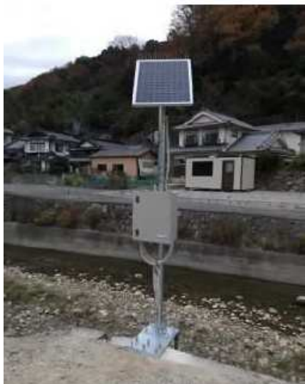
簡易型監視用カメラ 【設置例】
